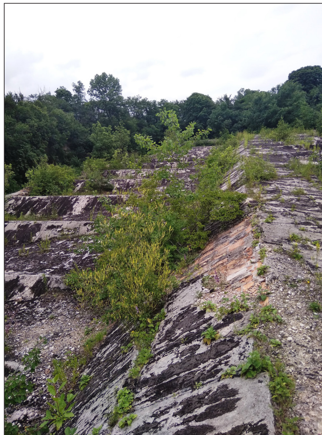
Фото 6. Залишки бітумного покриття.
